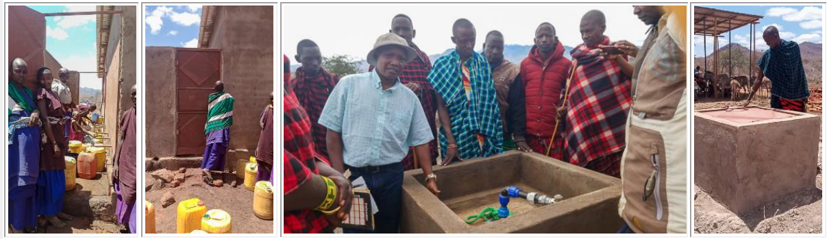
Geschützter Bereich für die Wasserentnahme am Pumpenhaus, Sicherung des Bohrloches in Mbaro, Juli 2022
